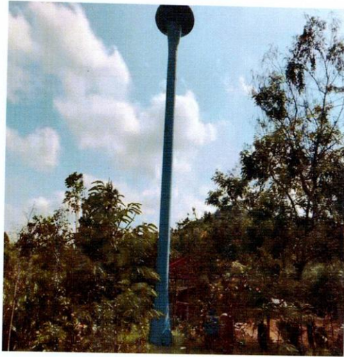
รูปภาพระบบประปาดาลบ้านห้วยน้ำผุด (เขมแปน) หมู่ที่ ๗
