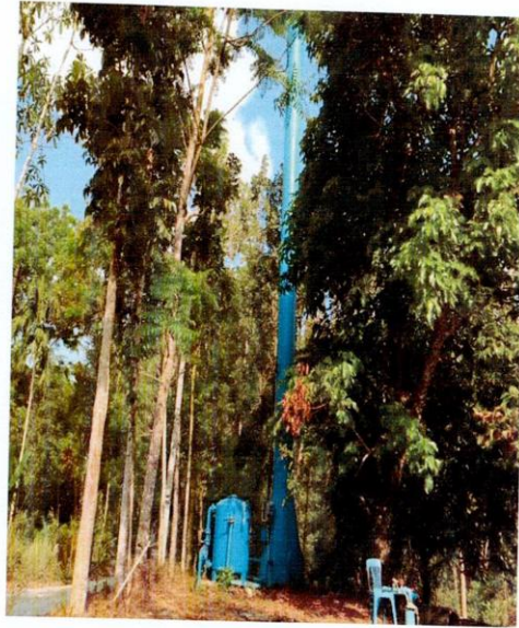
รูปภาพระบบประปาแบบบาดาล บ้านทับควาย (แบบถังเข็มแปญ) หมู่ที่ ๘
