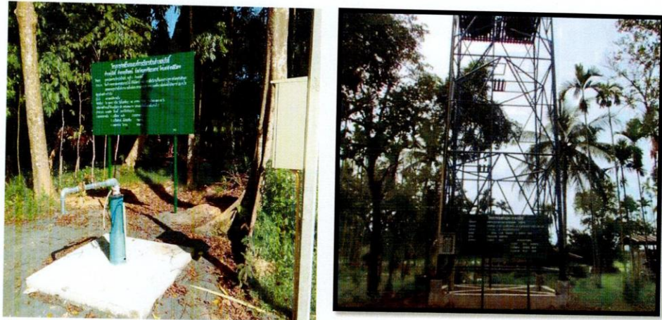
รูปภาพระบบประปาบาดาล ออกวัดสำนักขันธ์ หมู่ที่ ๔
