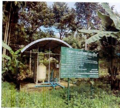
รูปภาพระบบประปาบาดาลขนาดใหญ่ที่บ้านห้วยน้ำผุด หมู่ที่ ๗
